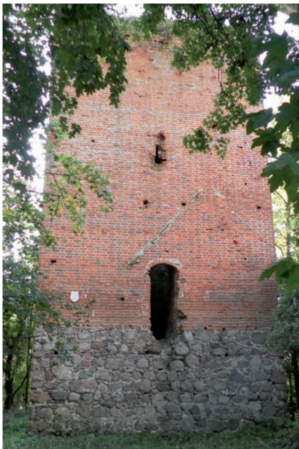
Abb. 3 - Nehringen, nördliche Seite des Wehrturmes mit Eingang und Resten des Satteldaches vom späteren Anbau.
